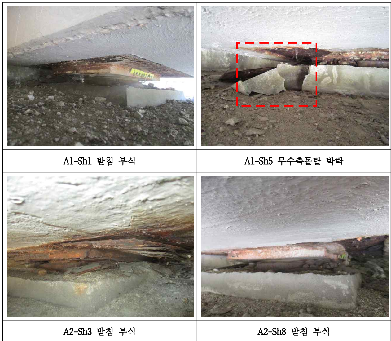
【사진 3.10】 교량받침 손상현황
